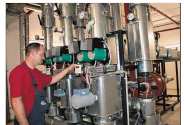
Reinhard Lehmann überprüft die Heizungsanlage. Das Blechen Carré ist an das Fernwärmenetz angeschlossen.
